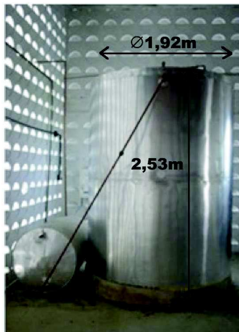
Figura 2.22 - Dimensões do tanque de armazenamento térmico de 7,35 m 3 de volume construído para o projeto do condicionador de ar adsorativo do LES.
