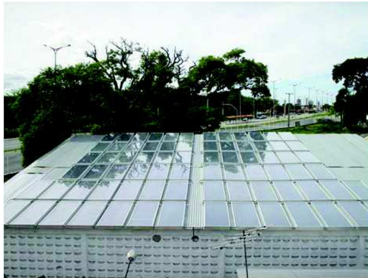
Figura 2.20 - Campo de coletores solares do ar condicionado adsorativo do LES.
