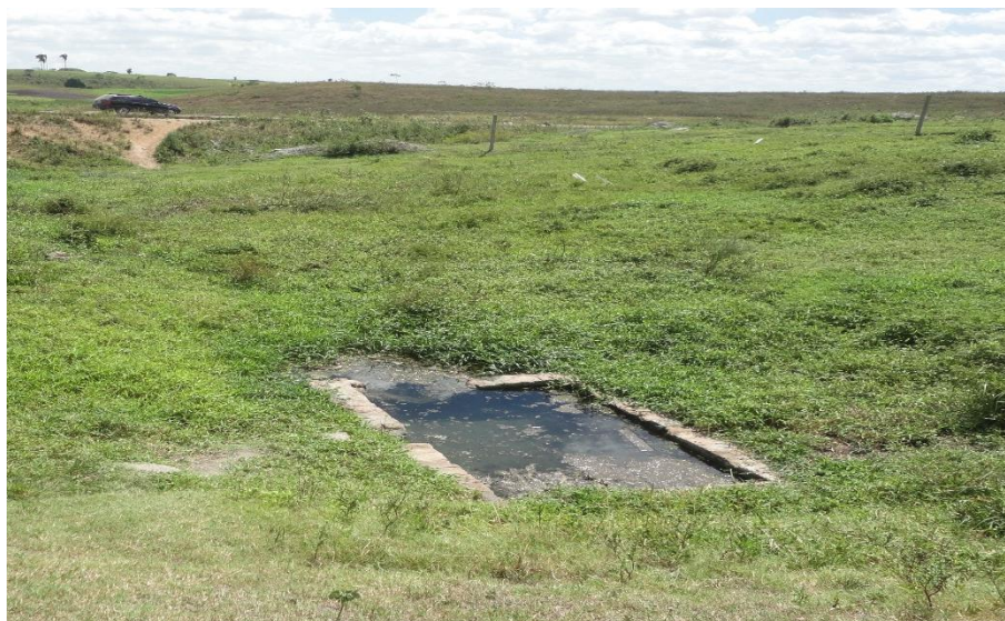
Figura 11 – Nascente Cacimba da Rosa antes do aterramento – Pedras de Fogo – PB
