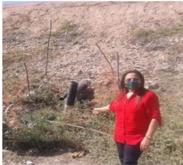
Figura 30 - Dreno de biogás no aterro do ASMOC
