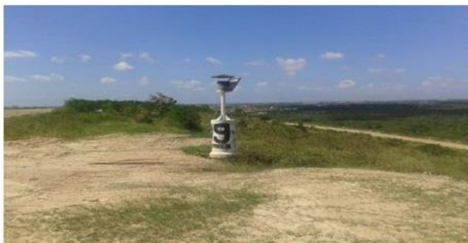
Figura 31 - Dreno de biogás com queimador no aterro ASMOC
