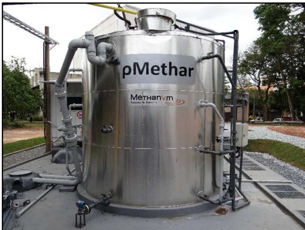
Figura 9: Reator de metanização de resíduos orgânicos
