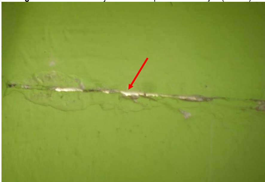
Figura 22- Problema na junta entre as placas de vedação (Casa 5)
