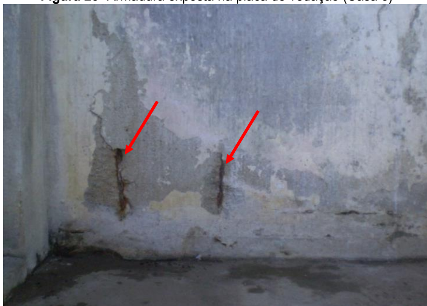
Figura 23- Armadura exposta na placa de vedação (Casa 3)
