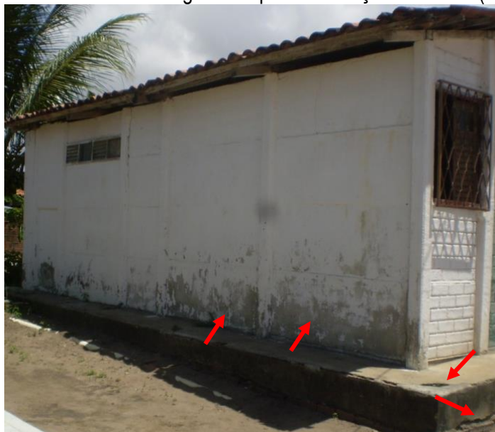
Figura 20- Parede com desgaste na pintura e calçada rachada (Casa 4)
