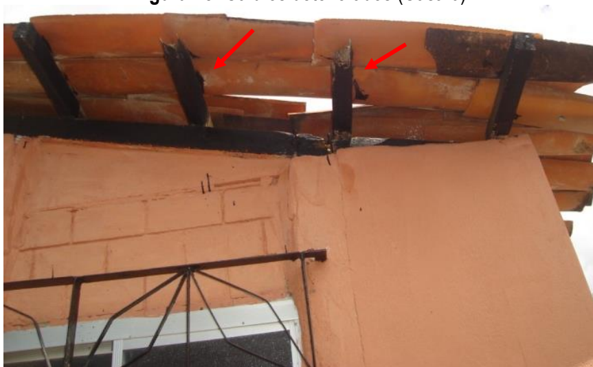
Figura 25- Caibros deteriorados (Casa 6)
