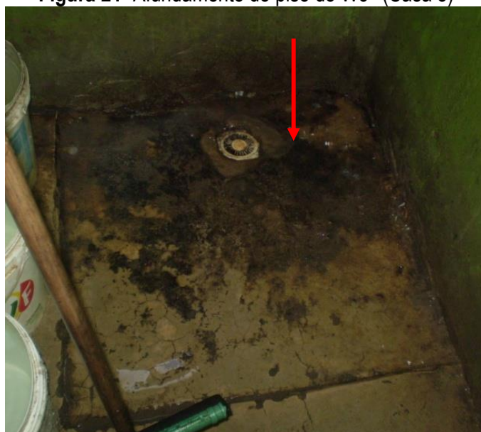
Figura 21- Afundamento do piso do Wc° (Casa 5)
