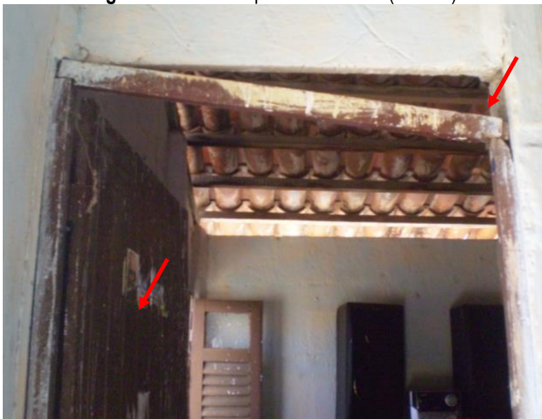
Figura 24- Forra da porta danificada (Casa 4)
