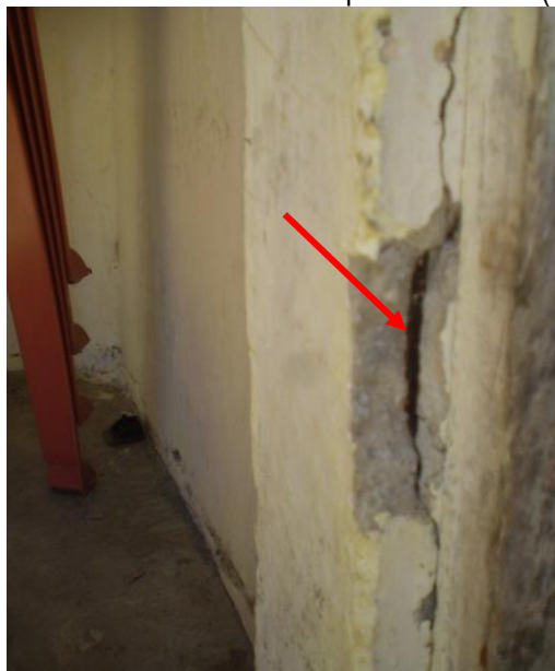
Figura 18- Pilar com armadura exposta e fissura (Casa 3)
