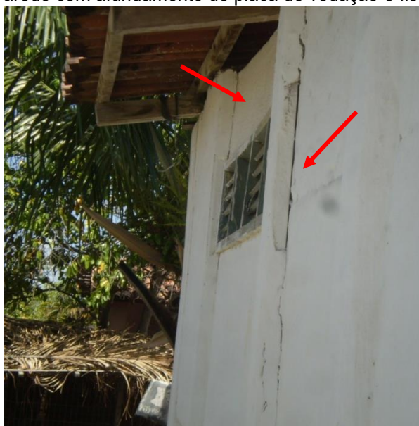
Figura 19- Parede com afundamento de placa de vedação e fissura (Casa 4)
