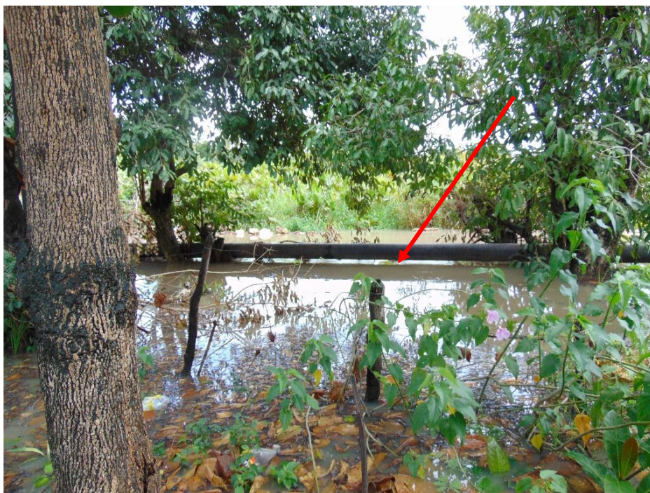
Figura 106 – Tubulação da Estação Elevatória da CAGEPA sob o rio Cuiá.
