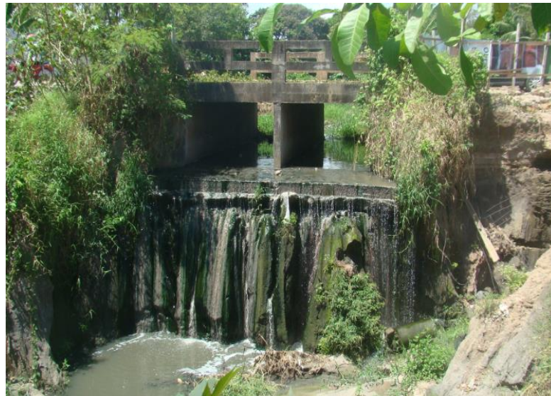
Figura 63: Ponte com erosão do rio Cabelo. – Estação de Coleta 2
