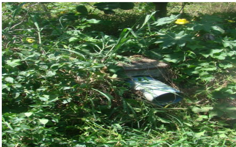
Figura 74: Extravasador da Estação Elevatória de Mangabeira
