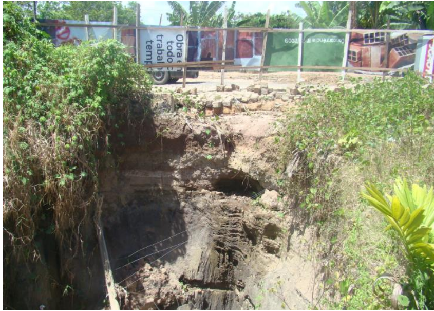
Figura 62: Foco de erosão no curso do rio Cabelo.
