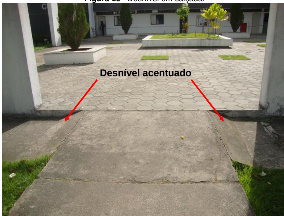
Figura 19 – Desnível em calçada.
