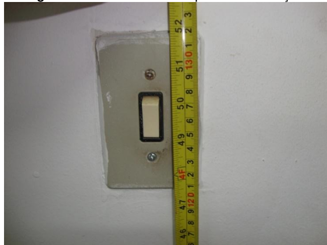
Figura 21 – Altura do interruptor de iluminação.
