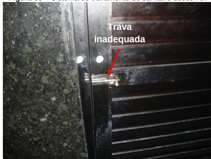
Figura 05 – Sistema de travamento do sanitário acessível.
