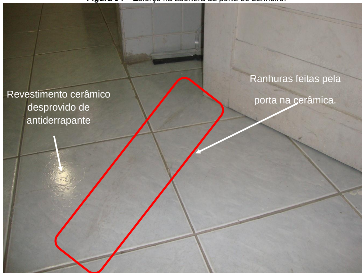
Figura 04 – Esforço na abertura da porta do banheiro.
