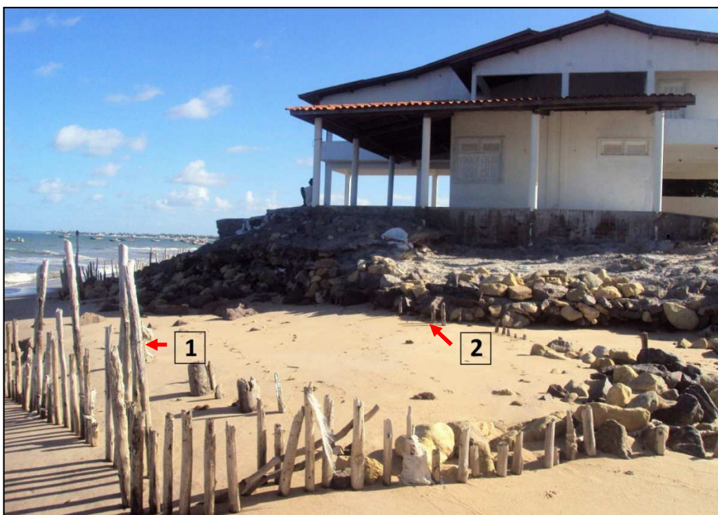
Figura 18: Aspectos de Erosão Costeira na Praia de Pitimbu
