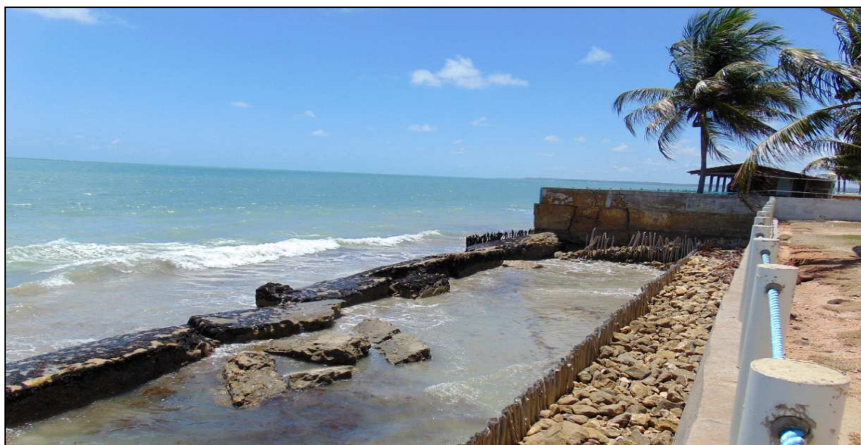
Figura 20: Aspectos Erosivos em Praia Azul
