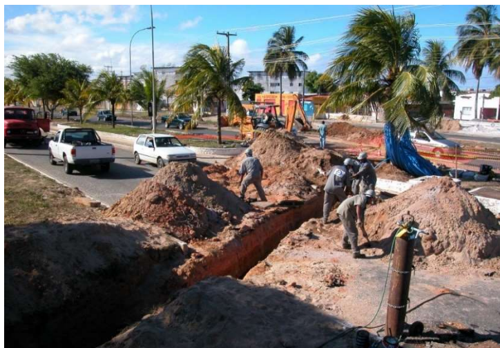
Figura 16 - Transtornos causados por valas em vias urbanas
